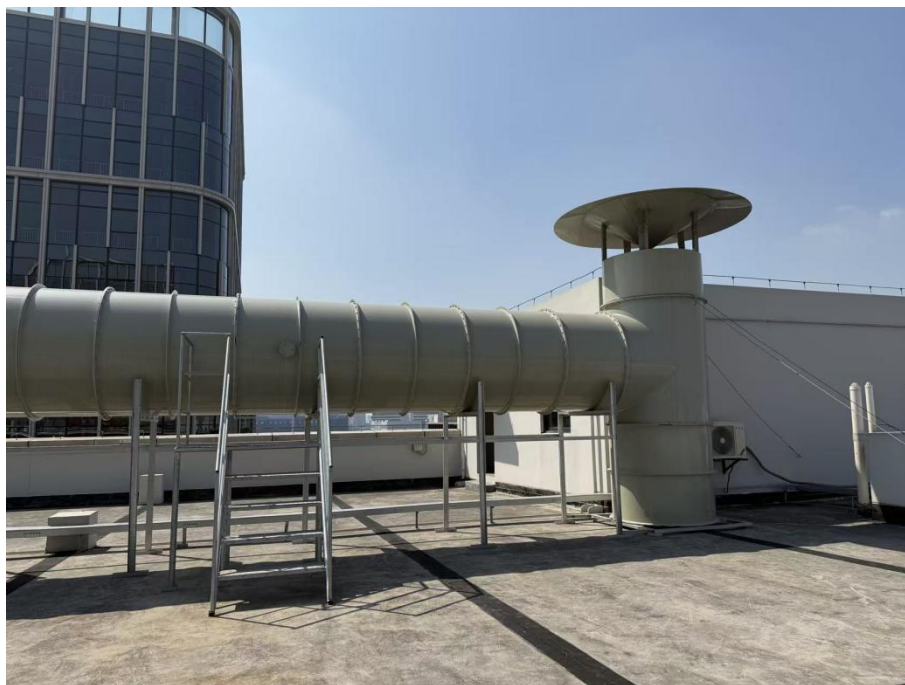
图 3-6 规范化标志牌和采样孔、检测平台
